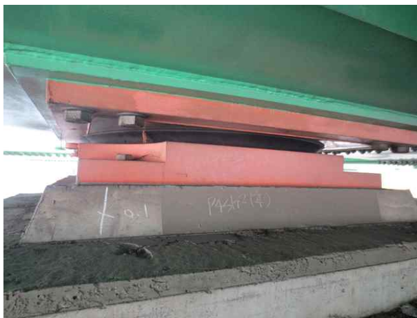
무수축물탈 균열(P4 Sh2)
